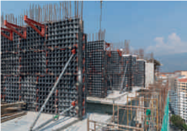
Primeiro uso com sucesso do sistema de cofragem leve para a construção de paredes resistentes
